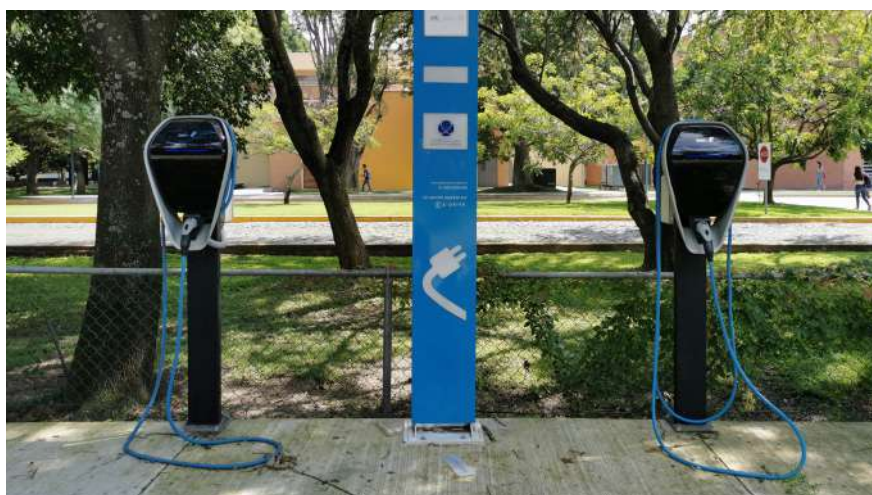
Imagen 21. Puertos de carga para vehículos eléctricos.
